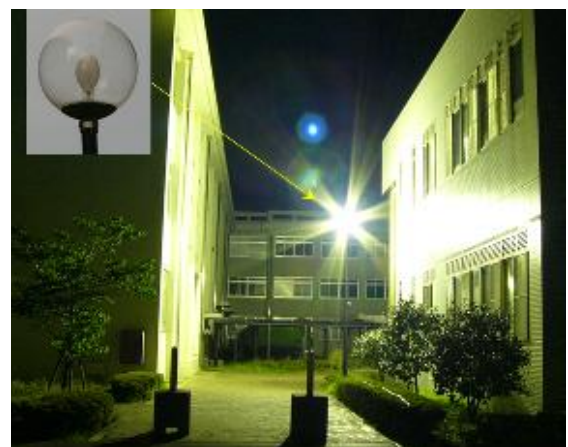
透明なガラスで覆われた「グローブ型」の照明器具は、周辺や夜空への光漏れ、強いグレアがあり、 屋外照明としては不適切
